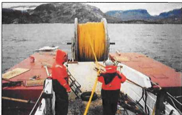
Opptak av utrangert kabel i Ståvatn på Haukeli. Av miljøhensyn skal all utrangert kabel fjernes. Her vises opptak av 4500 meter fiberkabel.
